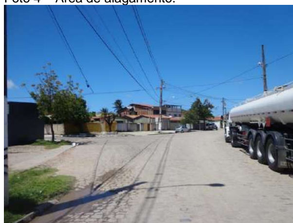
Foto 6 - Trecho com pequenos afundamentos na trilha da roda externa.
