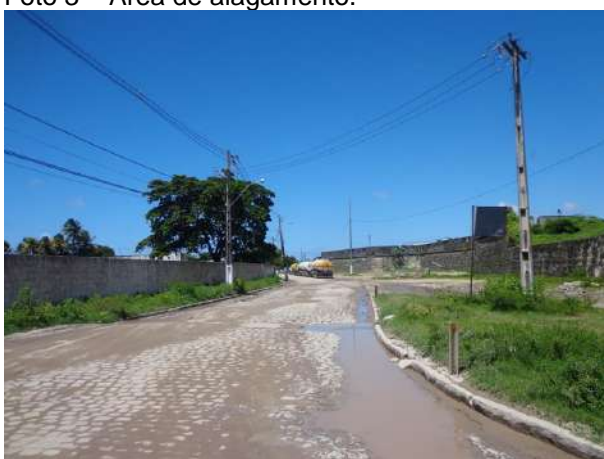
Foto 5 – Trecho com pequenos afundamentos na trilha da roda externa.
