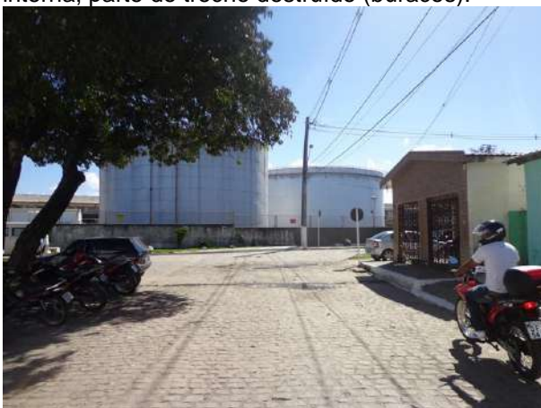
Foto 5 – Pavimento em paralelo destruído nas proximidades da rua Francisco Serafim.
