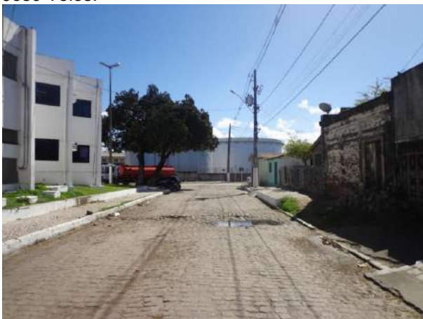
Foto 3 – Afundamento da trilha da roda externa e interna, parte do trecho destruído (buracos).
