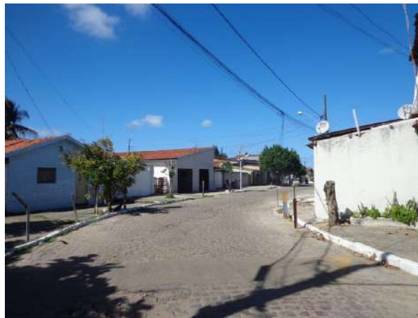
Foto 2 – Parte do pavimento em paralelo danificado, sem rejunto.
