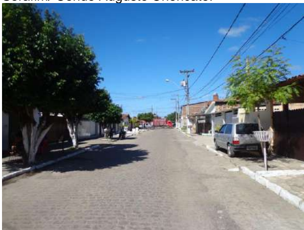
Foto 3 – Trecho com tapa buracos.
