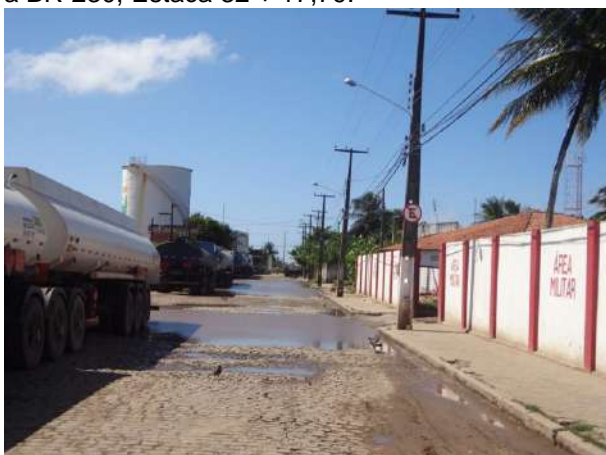
Foto 3 – Segmento bastante deteriorado, nas proximidades do Corpo de Bombeiros.
